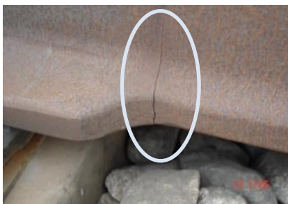
iii) Fracture – Section 4.1.3
